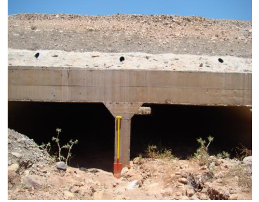
Off-site Schäden: Schäden außerhalb der Erosionsflächen
