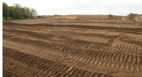
Abbildung 4: Einbau der Bodenschichten. Im Vordergrund die Speichermulde, im Hintergrund der großflächige Einbau des überschüssigen Unterbodens, © TG Berbisdorf
